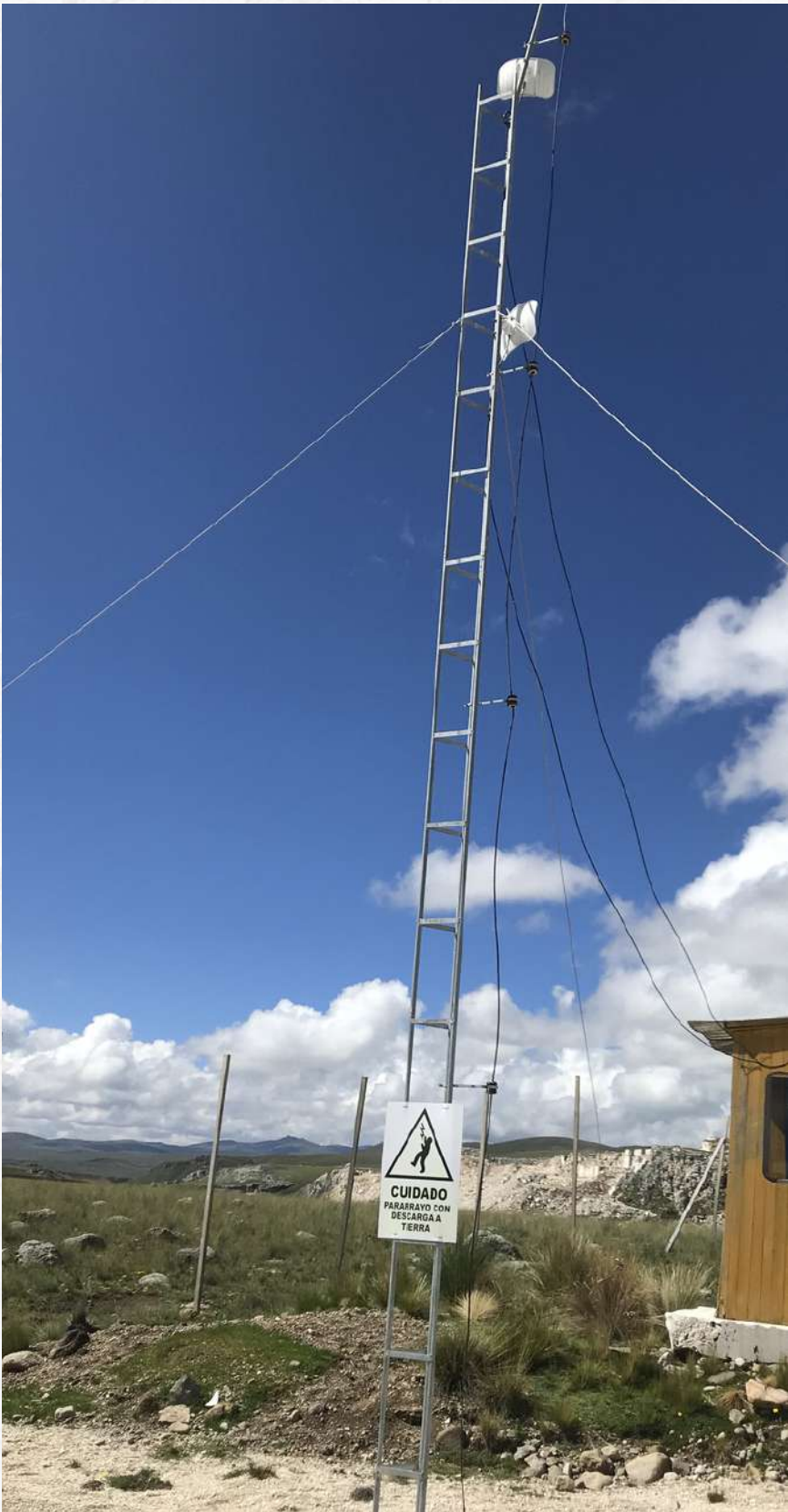
Pararrayos ubicado en el polvorín de la cantera
